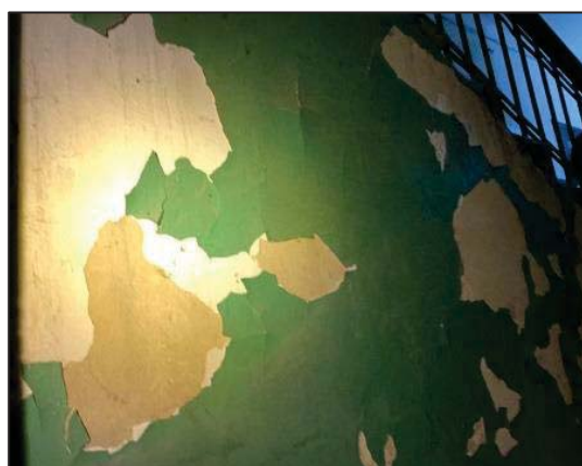
Рисунок 2 – Отслоение штукатурного слоя в подъезде
