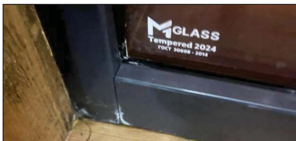
Рисунок 3 – Коррозия алюминия на подрезанных торцах
