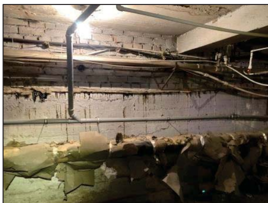
Рисунок 1 – Подвальное помещение жилого дома
