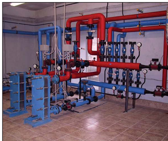
Рисунок 1 – Внешний вид автоматизированного теплового пункта (АТП)
