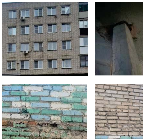
Рисунок 1 – Повреждение строительных конструкций дома по ул. Кулагина, 25, г. Барнаула вследствие их отсыревания Источник: фотографии автора
